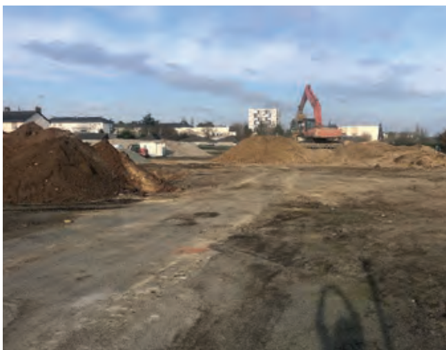
À gauche, de haut en bas : >>> ZAC des coteaux du Thouet (début des travaux) >>> Lotissement, route de Loudun (début du chantier)
